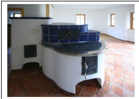
Obr. 9 Akumulační pec kombinovaná s kamny na vaření je umístěná uprostřed domu v přízemí. Do pece se dá naložit 10kg dřeva a vydrží nahřátá 24 hodin. V tu dobu je stěnové topení v přízemí a v hale 1. patra vypnuté.
