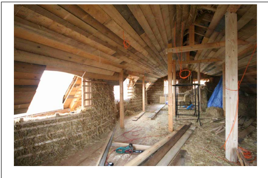
Obr. 6 Pohled do prostoru 1. patra. na rozpracované stěny a stropní podbití prkny. Na vodorovné latě na stěně vlevo na fotografii přijdou svisle nabít prkna tl. 24mm. Na nich bude rákosová rohož, nízkoteplotní stěnové topení a hliněná omítka v tloušťce 20 – 30mm realizová z hlíny z místa stavby.
