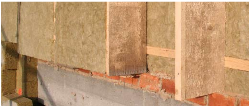
Detail zateplení minerální vlnou. U nízkoenergetických staveb se velké vrstvy měkkých tepelných izolací vkládají do dřevěného roštu. Laťování je křížené po vrstvách, aby se zmenšily tepelné mosty v konstrukci
